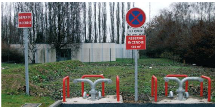
Signalisation d'une réserve incendie
