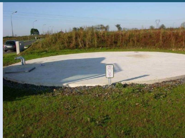
Réserve enterrée avec 2 sorties de 100 mm
