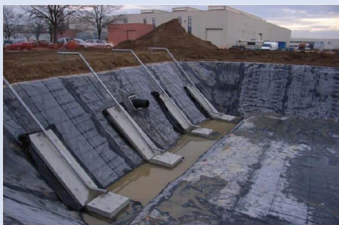
Colonnes fixes d'aspiration (réserve d'incendie ouverte)
